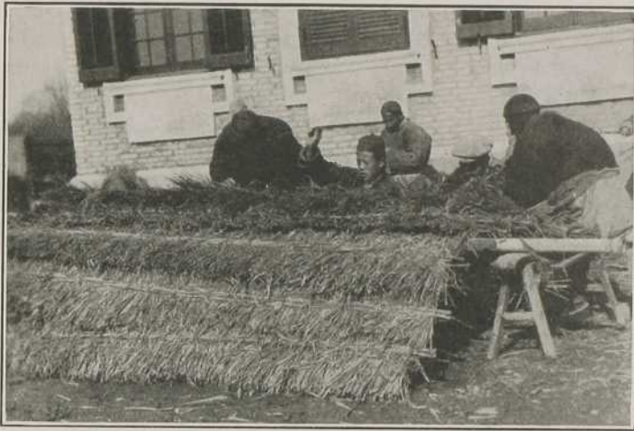
COMMENT L'ON PRÉPARE LA COUVERTURE DES MAISONS DE PAILLE A TSUNGMING, CHINE
