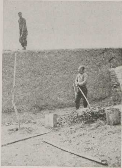
AU PRINTEMPS SE FAIT LA RÉPARATION DES MURS EN TERRE, À LA MISSION DE PAITCHENGTZE
