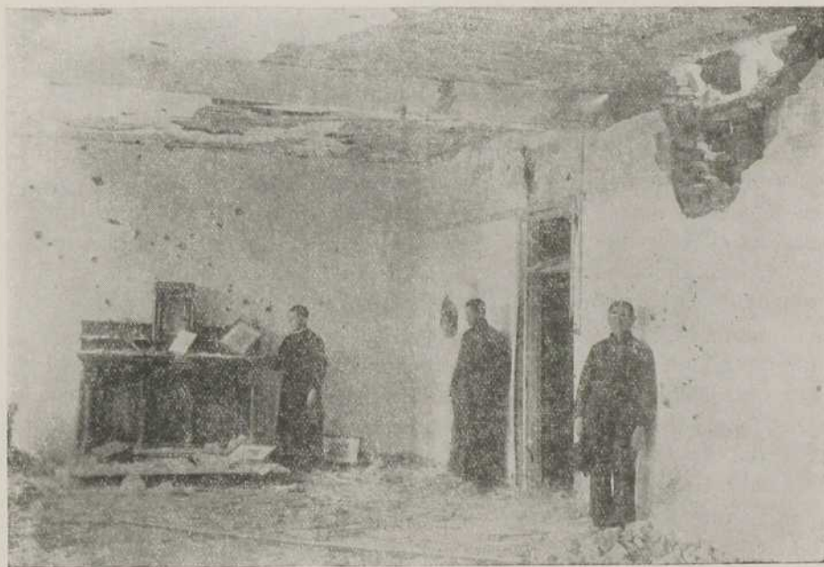
PITOYABLE ÉTAT DE LA CHAPELLE DU SÉMINAIRE DE SZEPINGKAI APRÈS LES BOMBARDEMENTS.
