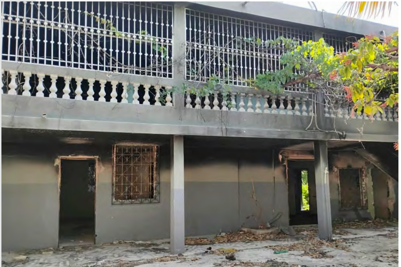
La maison provinciale M.I.C. à Delmas 9 et 11 pillée par les gangs (archives et économat). Photo : M.I.C.
